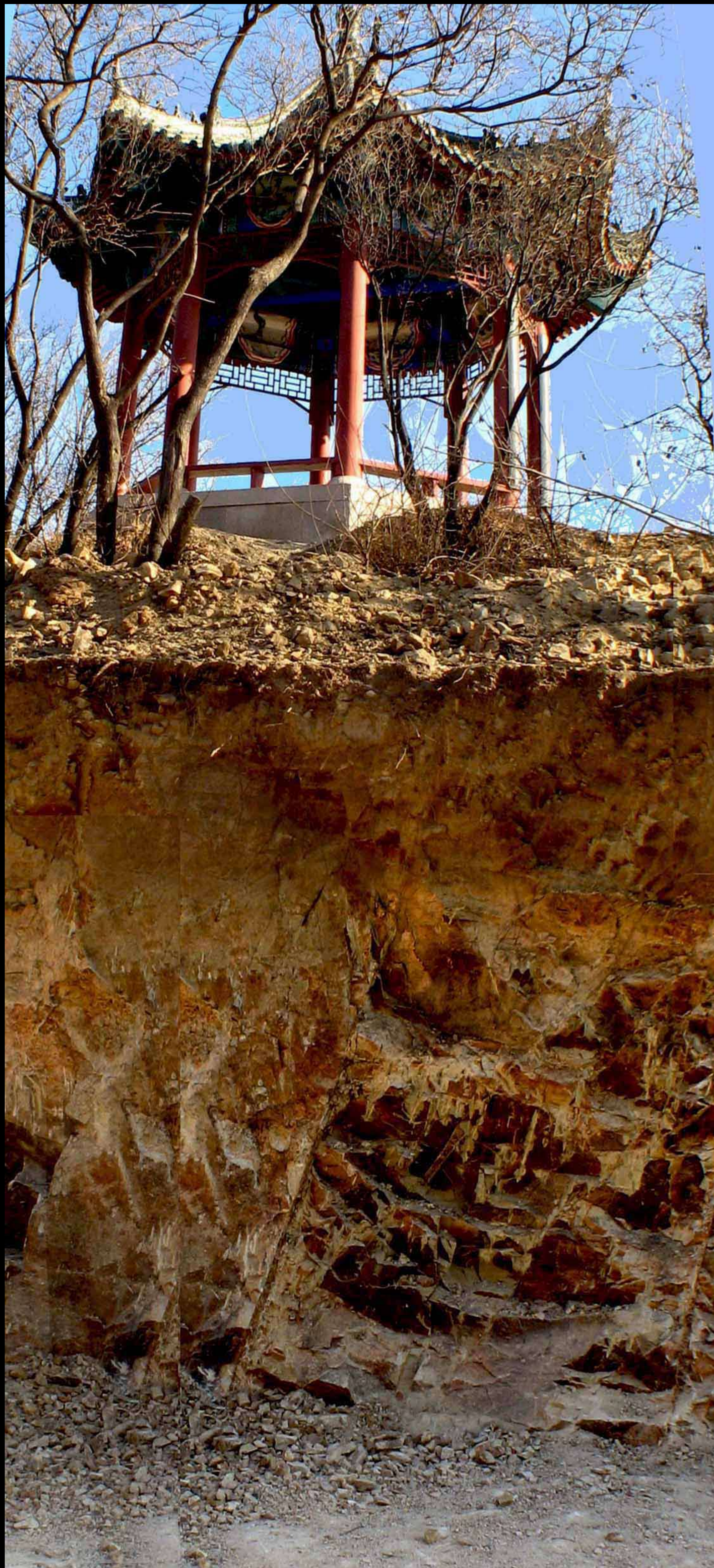
望乡亭基地岩石层，施工时下挖约3米左右，工人师付很辛苦
